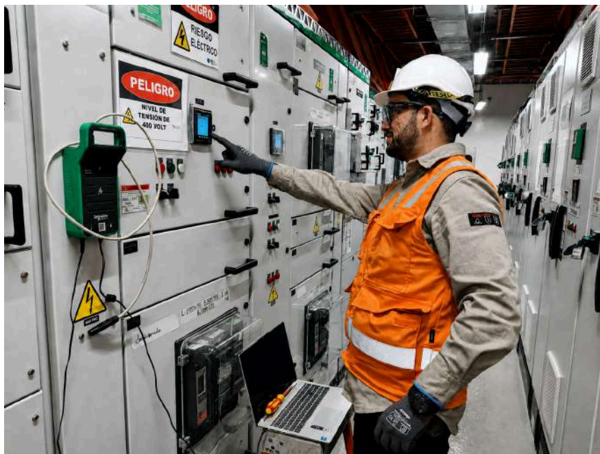
Técnico FEN configurando protecciones en sala eléctrica CCM — Planta Desaladora Tocopilla. Equipo Schneider conectado al tablero de 400V.
