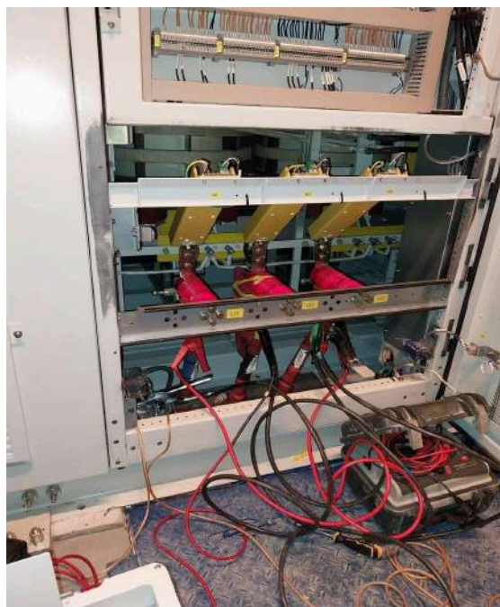
Interior de conexiones de potencia y medidor de aislación conectado.
