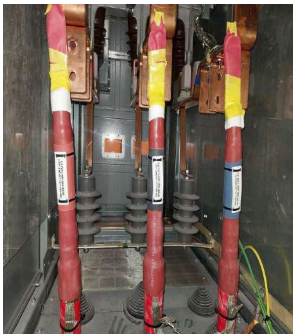
Terminaciones de cables MT marca Raychem en celdas del SWG.
