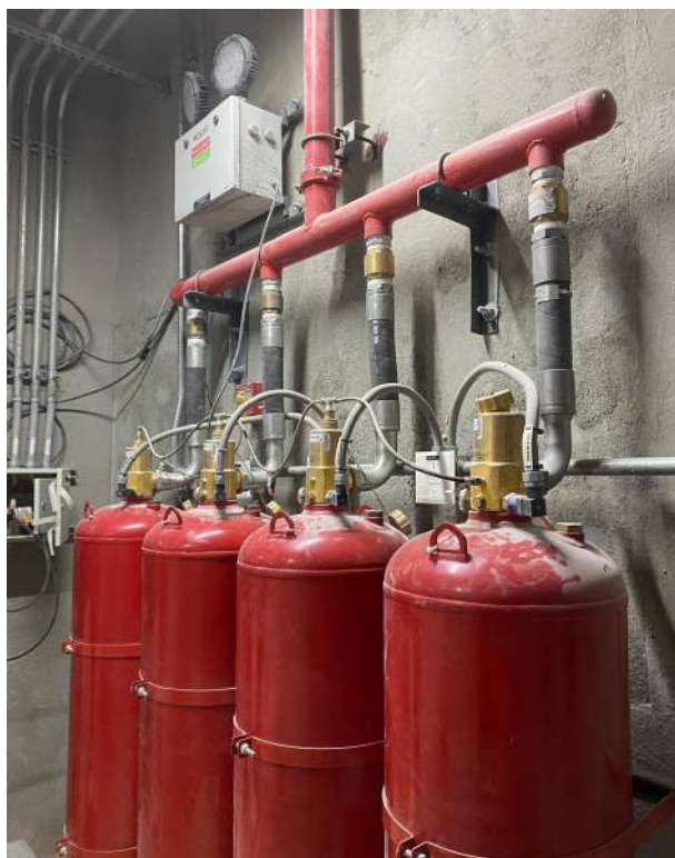
Batería de cilindros Novec 1230 con manifold de distribución y panel de control KOLFF instalados.
