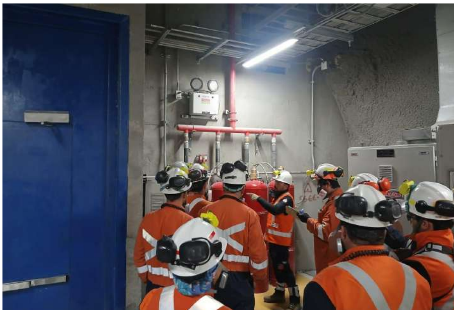
Sesión de capacitación al personal de Codelco Chuquicamata frente al sistema de extinción Novec 1230 instalado en sala eléctrica 222540-SEL-001.
