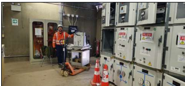
Técnico FEN junto a switchgear MT en sala eléctrica.
