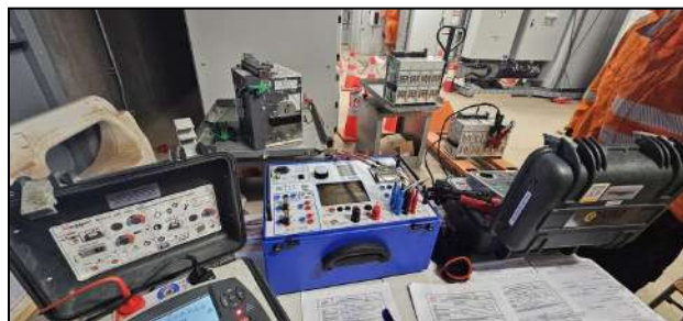
Instrumentación y equipos de medición para pruebas de protecciones.
